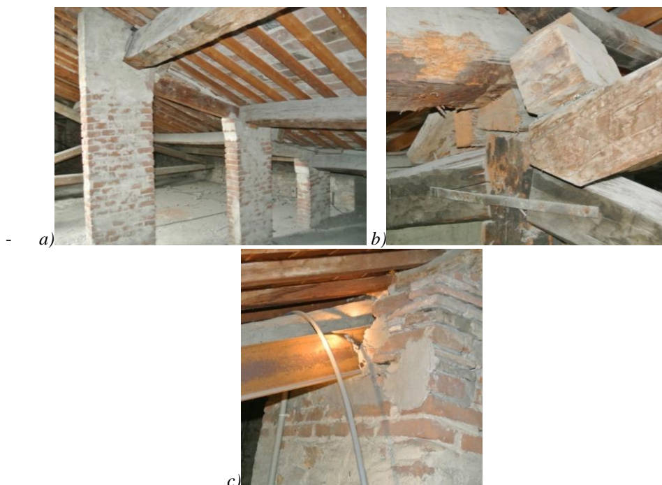
- Figura 11.13: Alcuni dettagli delle capriate in legno: a) appoggio in corrispondenza del colmo della capriata, b) appoggio della capriata sulla muratura, c) muretti di sostegno presenti nel sottotetto.
