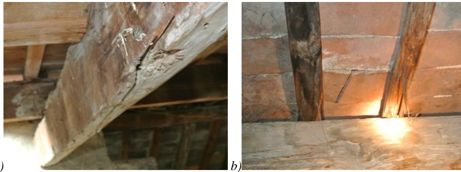
Figura 11.10: a) Esempio di elemento di capriata in legno ammalorato, b) ammaloramento del manto di copertura.
