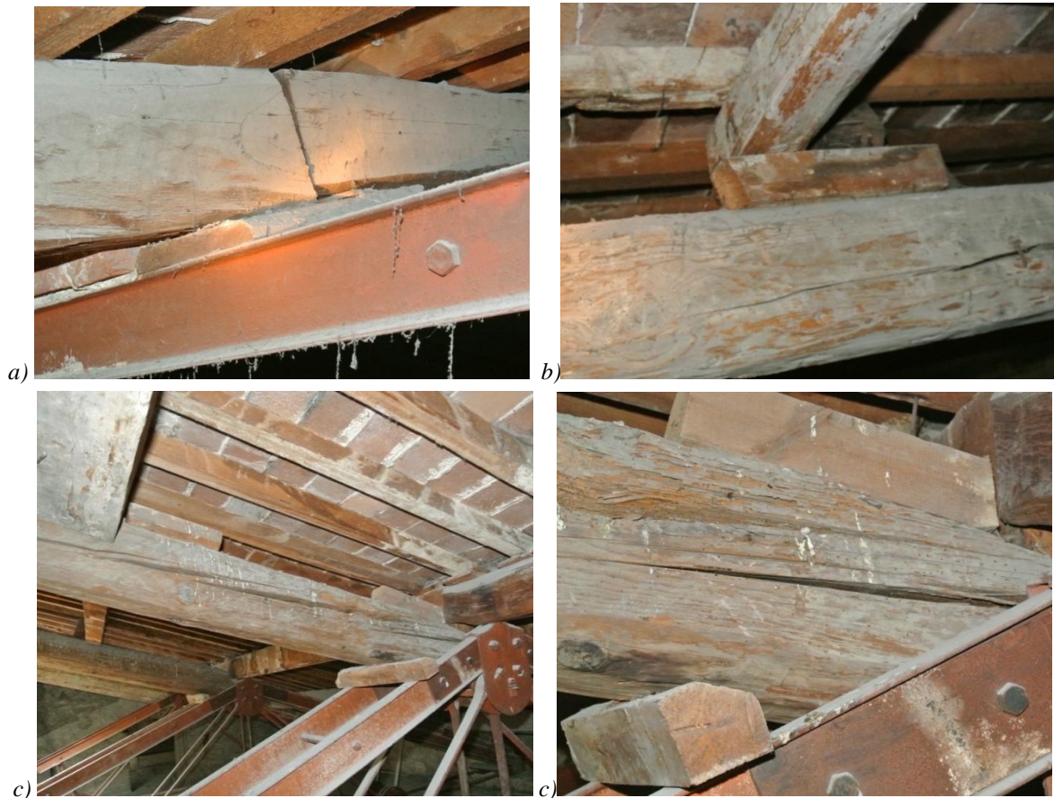
Figura 6.63: Alcuni dettagli degli appoggi delle travi in legno sulle capriate in acciaio (lato Piazza Dante).
