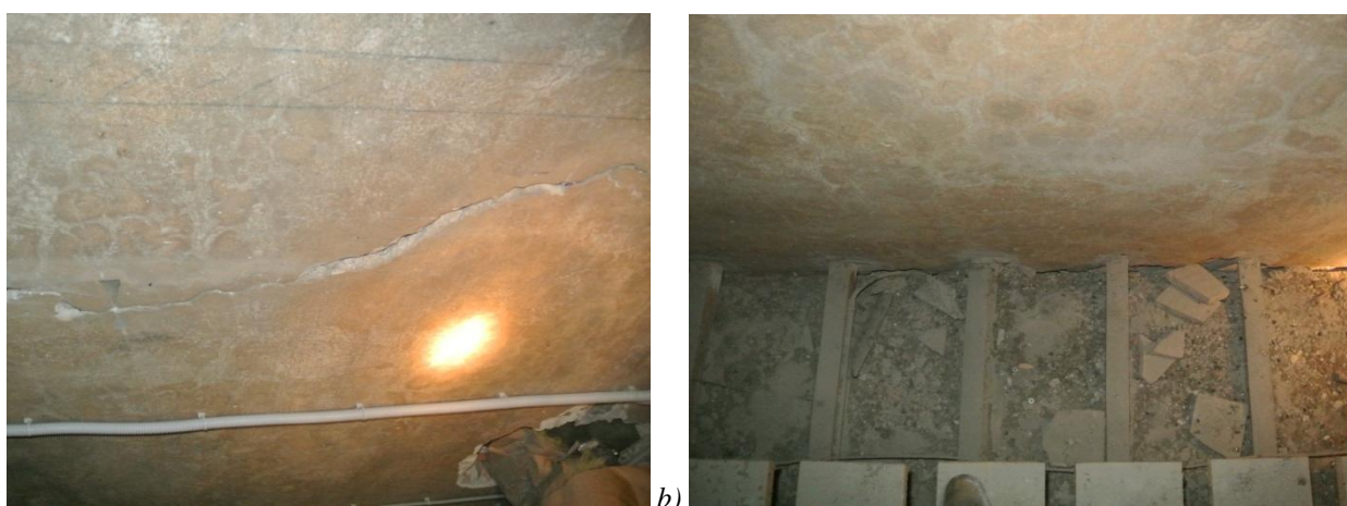
a) b) Figura 6.72: a) Lesione nella parete di separazione tra le due parti del tetto lato Vicolo dell'Ulivo, b) dettaglio sfilamento dei travicelli del solaio del sottotetto.
