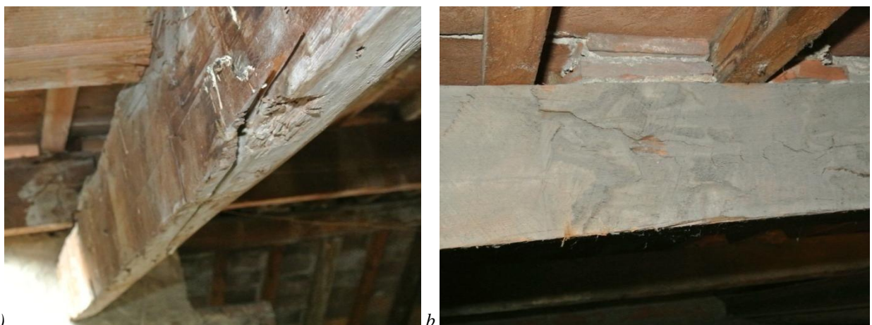
Figura 6.64: a) lesioni in corrispondenza della trave in legno (copertura lato Piazza Dante), b) ammaloramento della trave in legno (copertura lato Piazza Dante, interno porticato).
