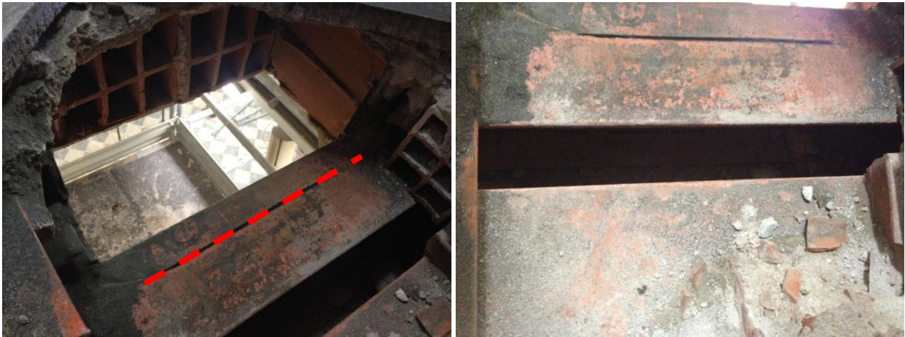
Figura 8.14: Individuazione del campione di acciaio da prelevare dalla flangia superiore di uno dei due profili IPN400 che costituiscono la trave dell'orditura principale.
