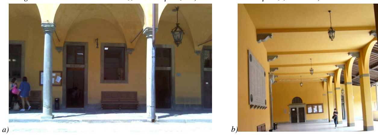
Figura 1.3: Il porticato al piano terra e al piano primo (colonnato, dettaglio solaio).
