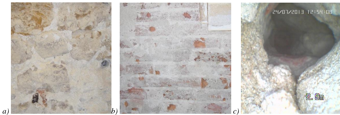
Figura 6.14: a) Esecuzione dell'endoscopia in corrispondenza del saggio TM/09B/PT, b) Saggio TM+C/09A/PT, c) End./09BPT, Profondità 25 cm.
