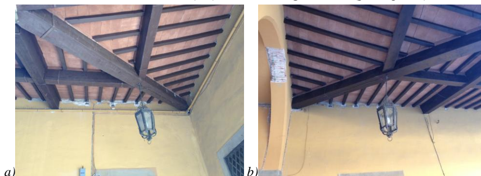
Figura 11.9: Sfilamento dei travicelli della copertura del porticato al piano primo: a) angolo tra Via della Sapienza e Via Curtatone e Montanara, b) angolo tra Piazza Dante e Via dell'Ulivo.
